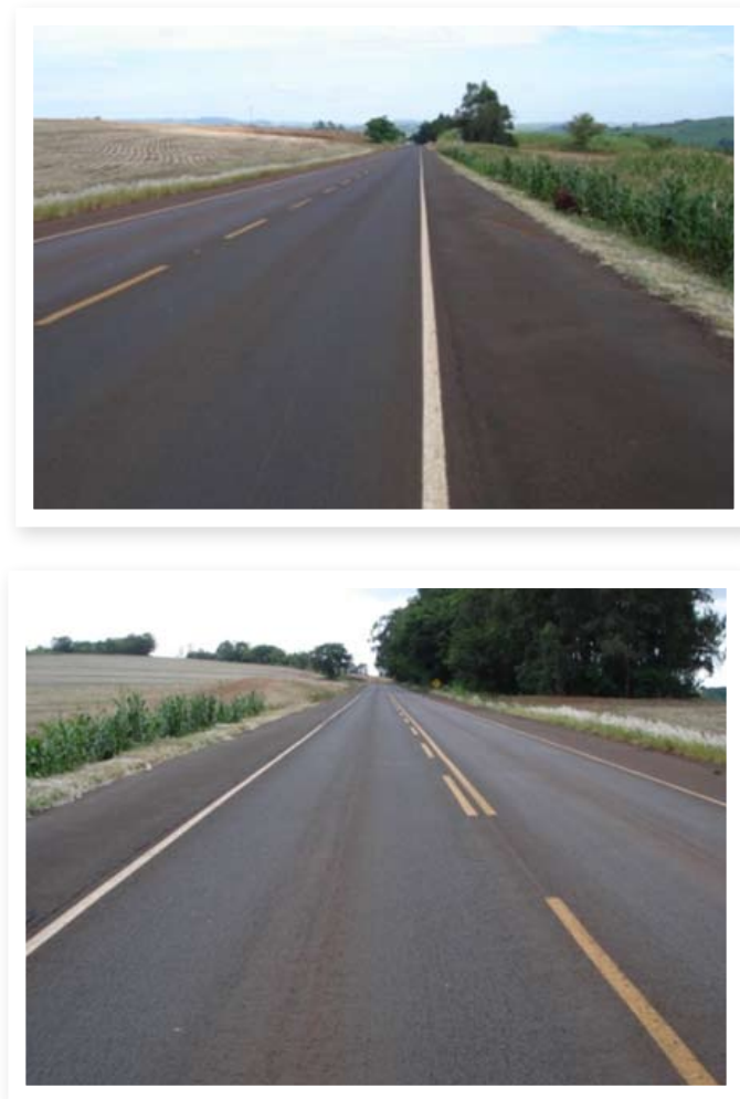
Figura 8 - Condições gerais de trechos da rodovia recuperada – 1 ano após a aplicação.
