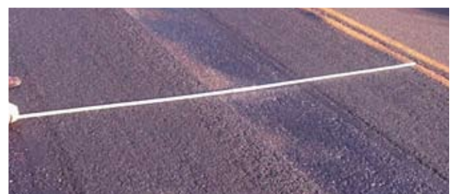
Figura 6 - Situação da trilhas de roda preenchidas após 2 dias de liberação ao tráfego.
