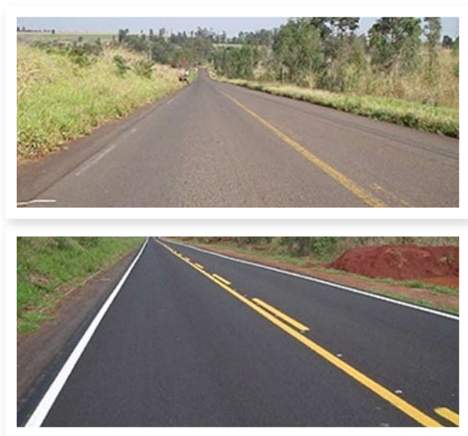
Figura 7 - Visão geral de trecho antes e depois da recuperação.
