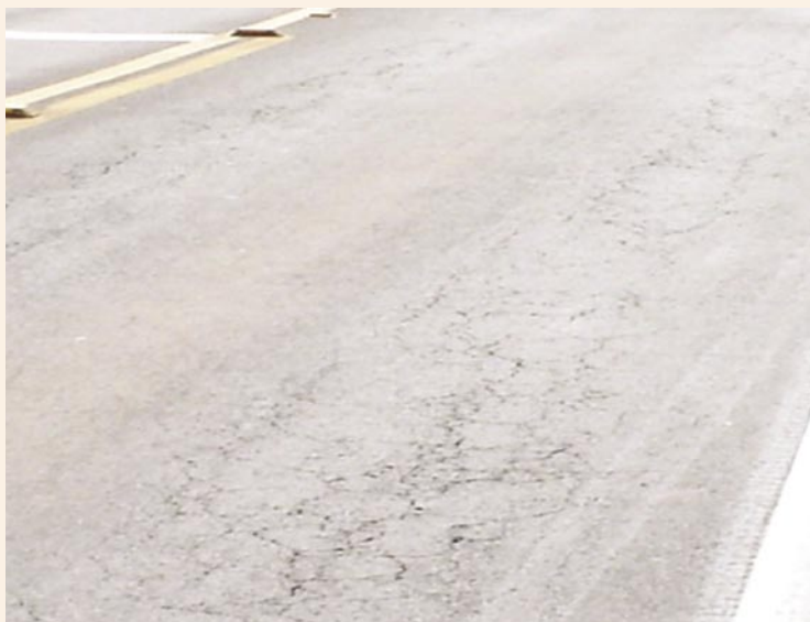
Trecho experimental – BR 116/RS – 3 anos – Asfalto convencional
